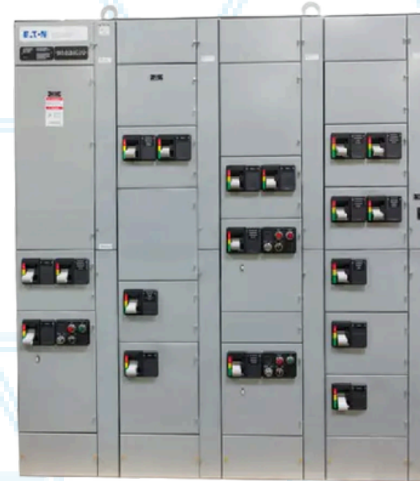
Centros de Control de Motores (CCM)
